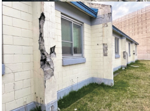
写真2、3 老朽化が進み、耐震基準も満たさない防衛施設
